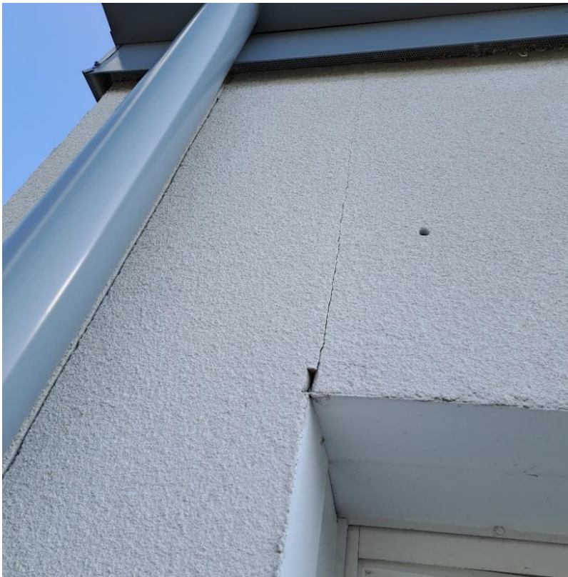
Kuva 5.2 Ikkuna-aukon kulmasta alkava halkeama, luonnostaan muodostunut liikuntasäama.
