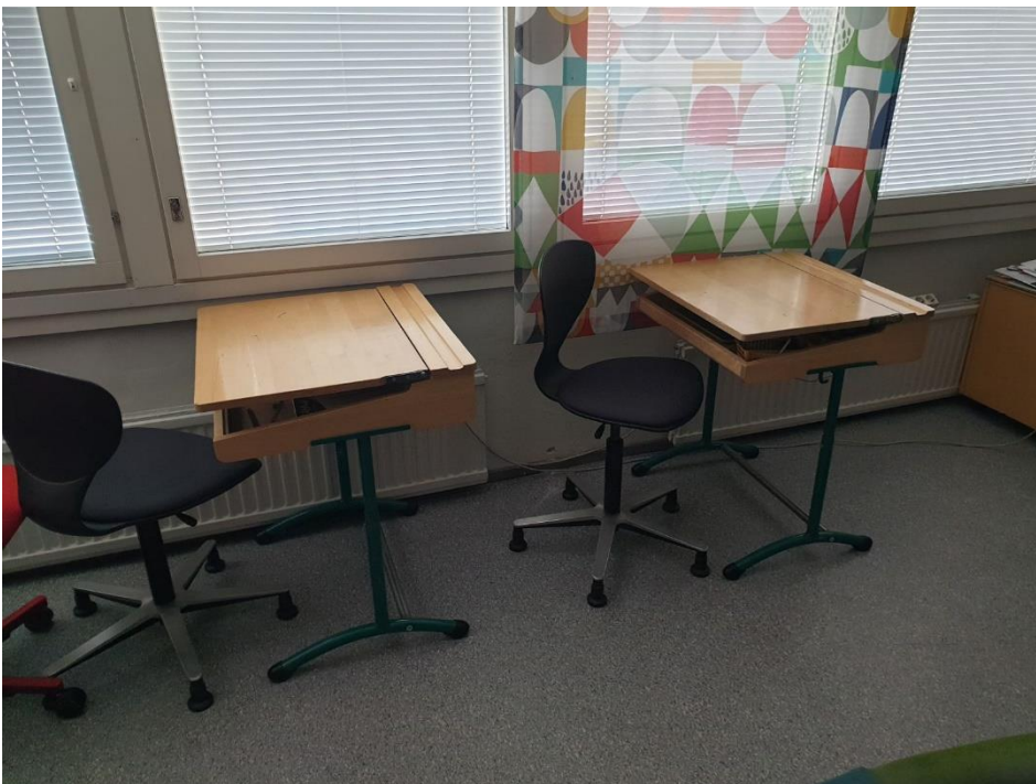
Kuva 8. Vanha osa, koululuokka, seinien maalipinnat mahdollisesti sisältävät haitta-aineita. Näytteet Asb/RM20 (Asb=asbesti, RM=raskasmetallit).
