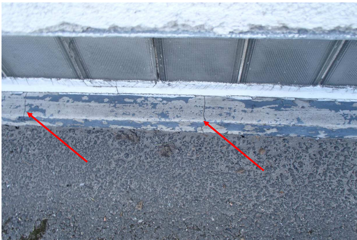
Kuva 33. Rakennuksen pohjoissivun sokkelissa havaittiin halkeilua ja sokkelin maalipinnat ovat ikääntyneet.
