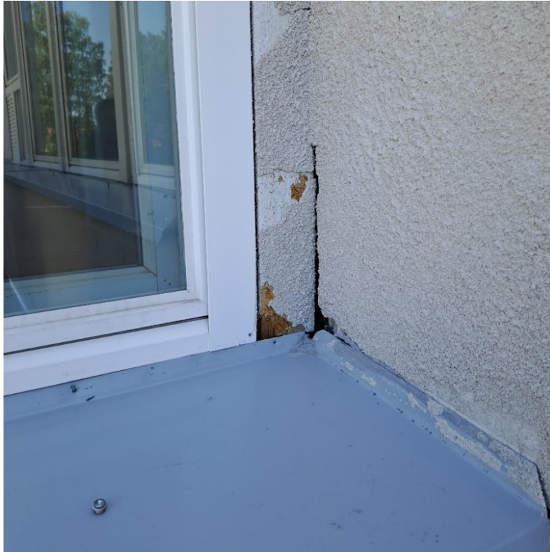
Kuva 5.11 Ikkunoiden tiiviys on paikoin puutteellinen. Kuvassa ikkunan reuna on peitetty lastulevyllä, joka on ajan saatossa vaurioitunut.
