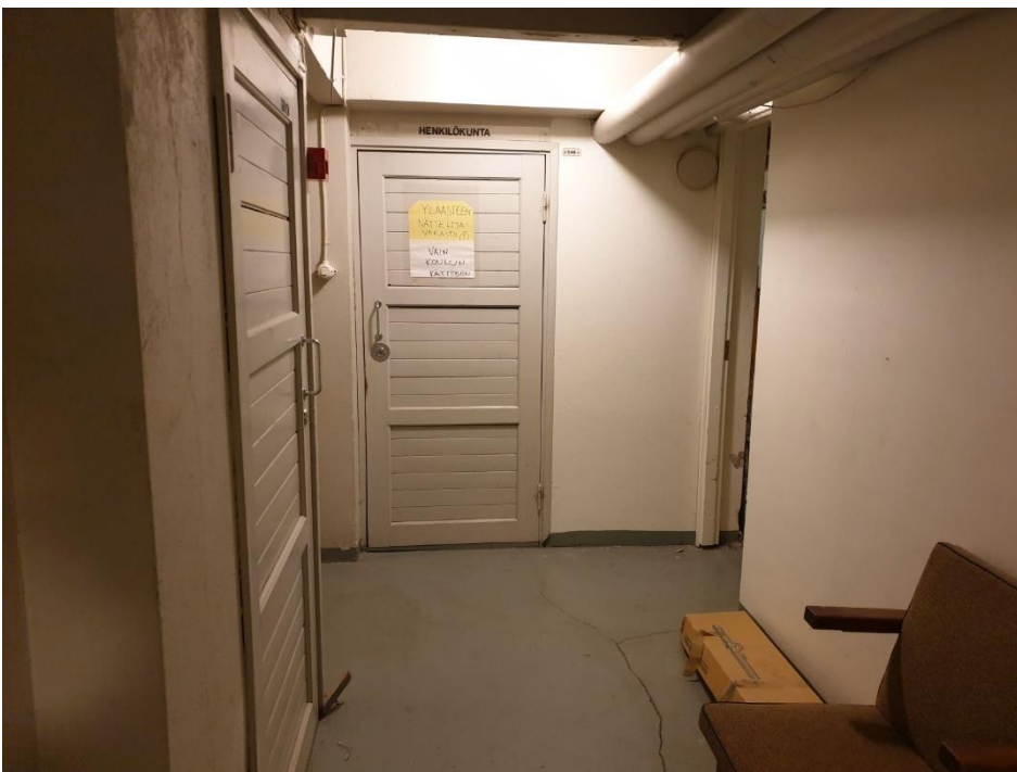
Kuva 6. Vanha osa, varastot, seinien ja lattia maalipinnat mahdollisesti sisältävät haitta-aineita. Näytteet Asb/RM19 lattia, Asb/RM23 seinät (Asb=asbesti, RM=raskasmetallit).
