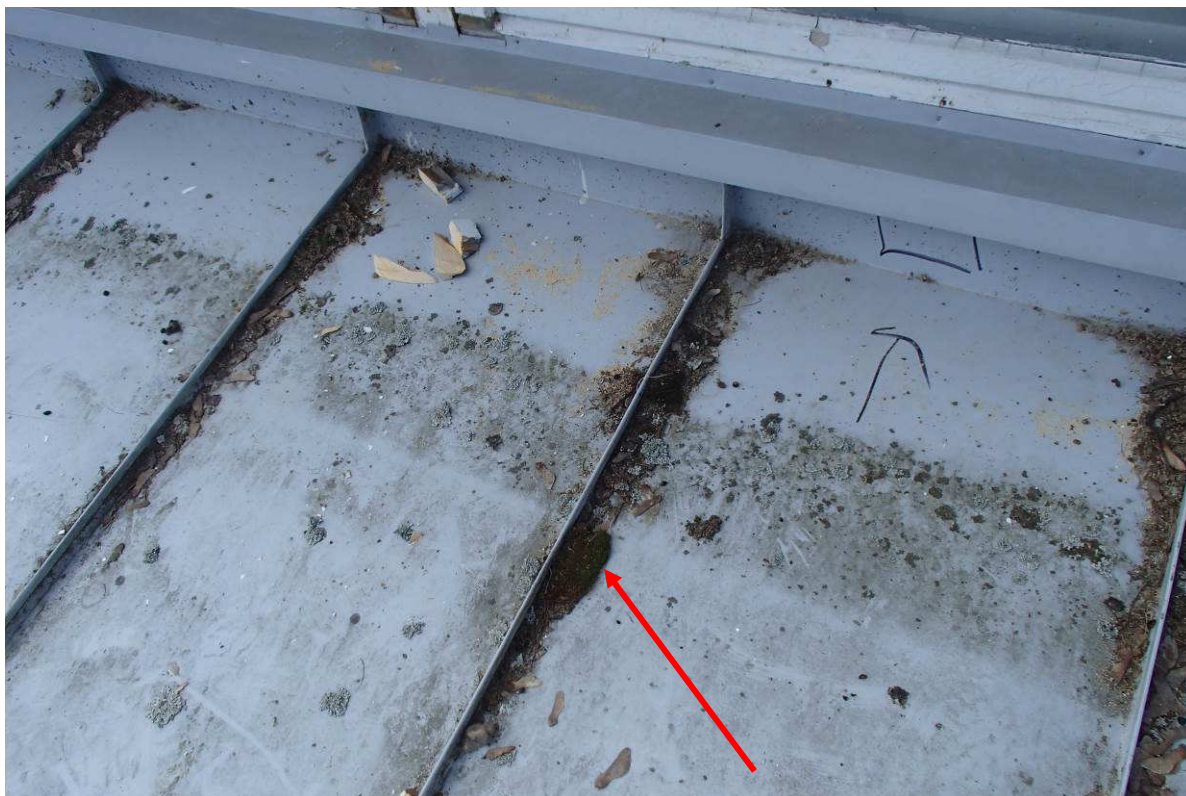
Kuva 44. Vesikaton päällä kasvaa paikoin sammalta.
