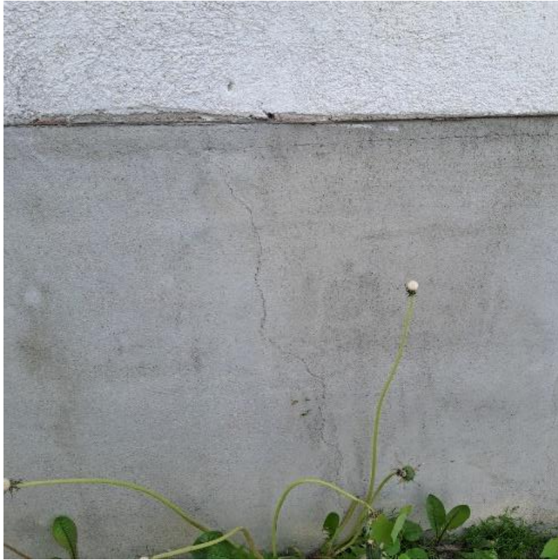
Kuva 5.22 Laajennuksen sokkelissa paljon kuvan mukaisia halkeamia
