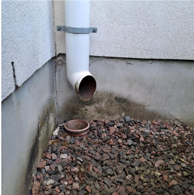
Kuva 5.24 Kuvassa näkyy sokkelin yläreunan halkeilua. Laajennuksen sokkeliin on kohdistunut myös paikoin kosteusrasitusta.
