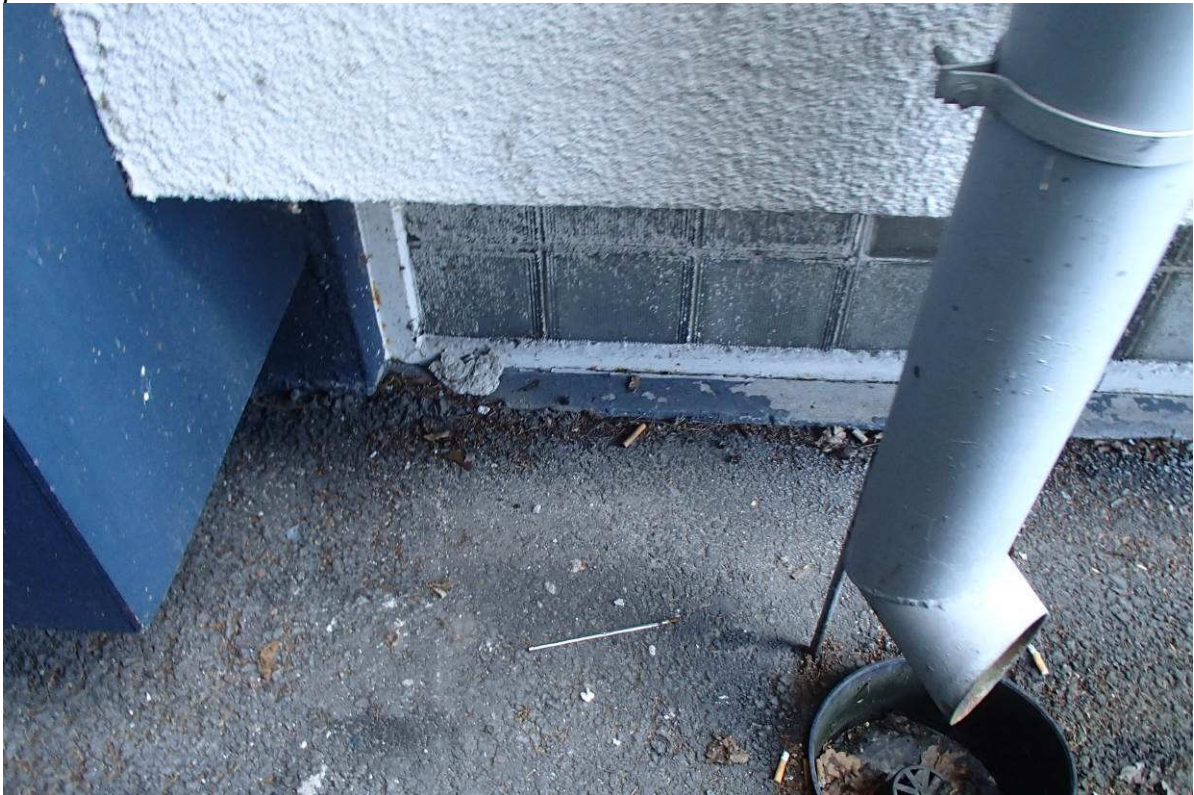
Kuva 35. Sokkelin yläpinta on paikoin samassa korkopinnassa piha-alueen kanssa.
