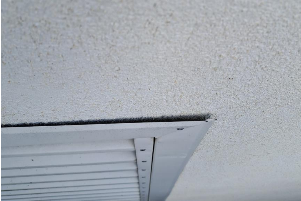
Kuva 5.30 Ilmanvaihtokanavan ritilä laajennuksen julkisivulla on epätiivis
