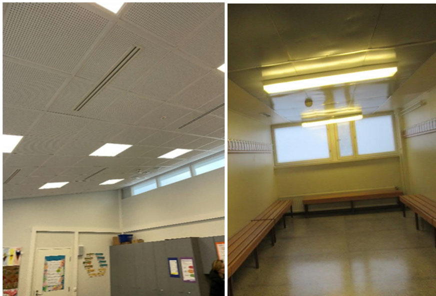
Kuvat 5.3.1-5.3.2: Esimerkkejä uusitusta ja uusimattomasta sisävalaistuksesta.
