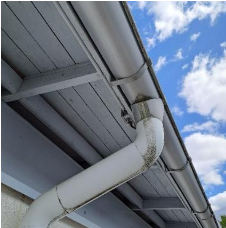
Kuva 5.27 Syöksytörvi vuotaa, ks. seuraava kuva
