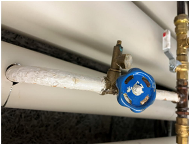
Kuva 4.1.1: Vanha lämmitysverkoston sulkuventtiili.
