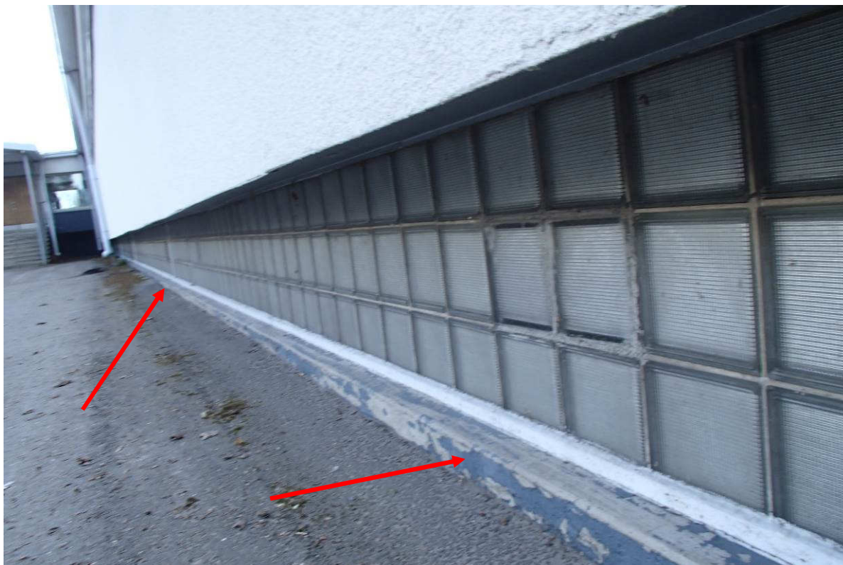
Kuva 32. Rakennuksen pohjoissivun sokkelit/maanpaineseinät ovat matalia.
