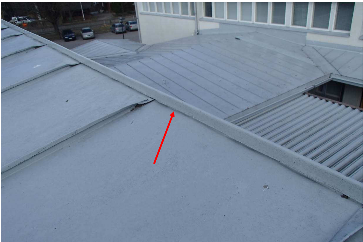
Kuva 51. Paikoin otsapellityksen liitokset eivät ole kaksinkertaiset.
