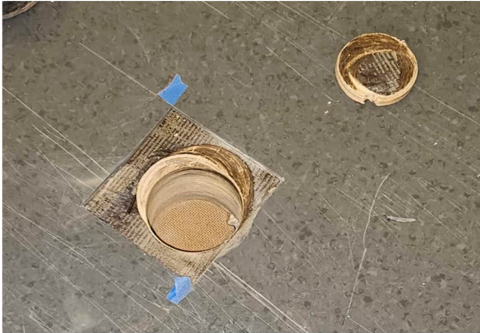
Kuva 1 Rakenneavaus voimisteluvälinevarastossa. Puukerrostun välissä on kovalevy.
