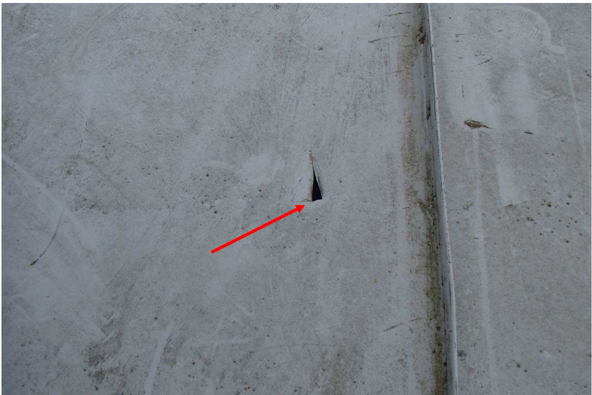
Kuva 41. Konesaumapeltikatteessa havaittiin reikiä.
