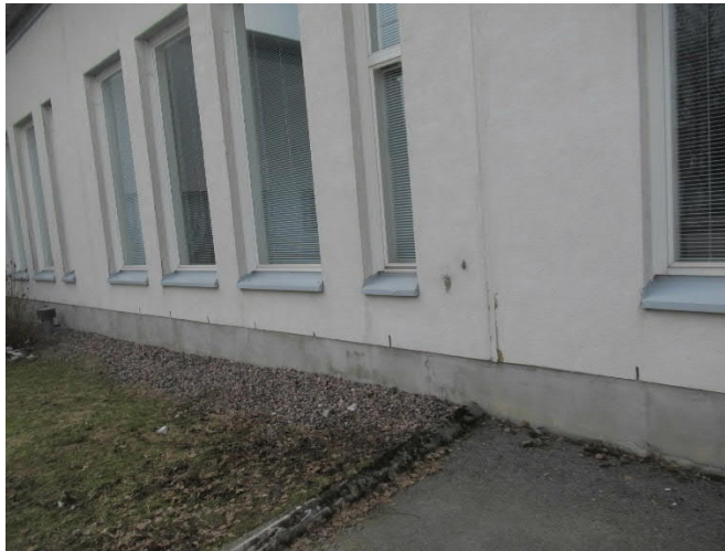
Kuva 3.2.1: Perusmuurien pinnoitteen hilseilyä. Kuntotutkimusta suositellaan, pinnoitekorjaukset aiheellisia.
