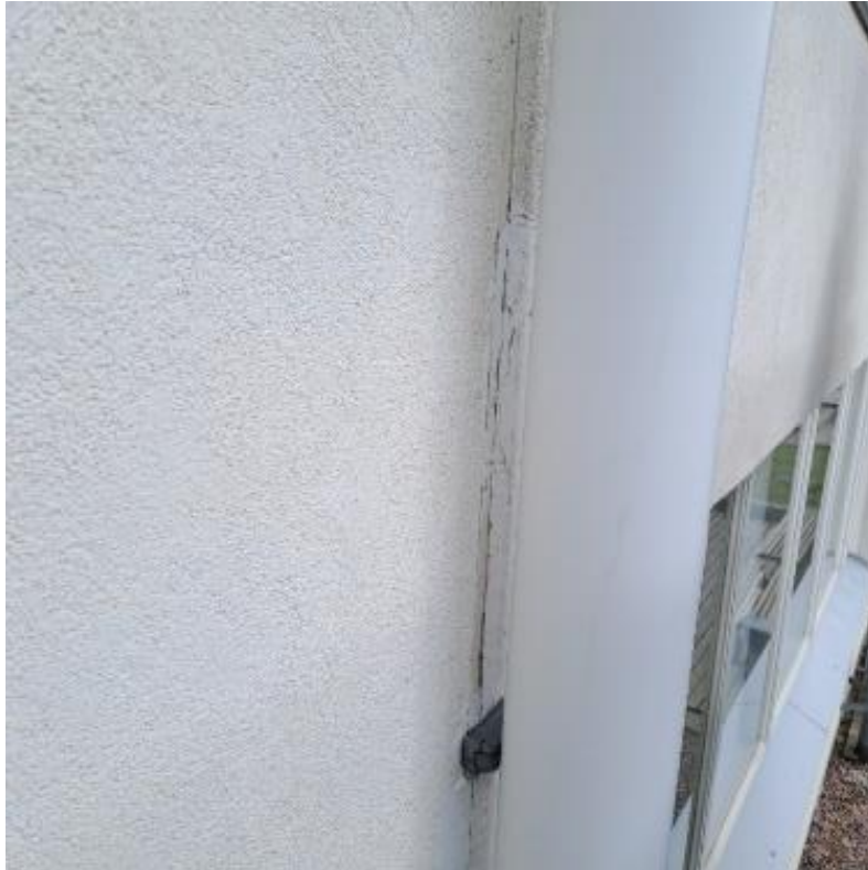
Kuva 5.28 Vuotava syöksytorvi on mahdollisesti vaurioittanut rappausta sauman ympärillä. Rappausta on paikattu aiemmin.
