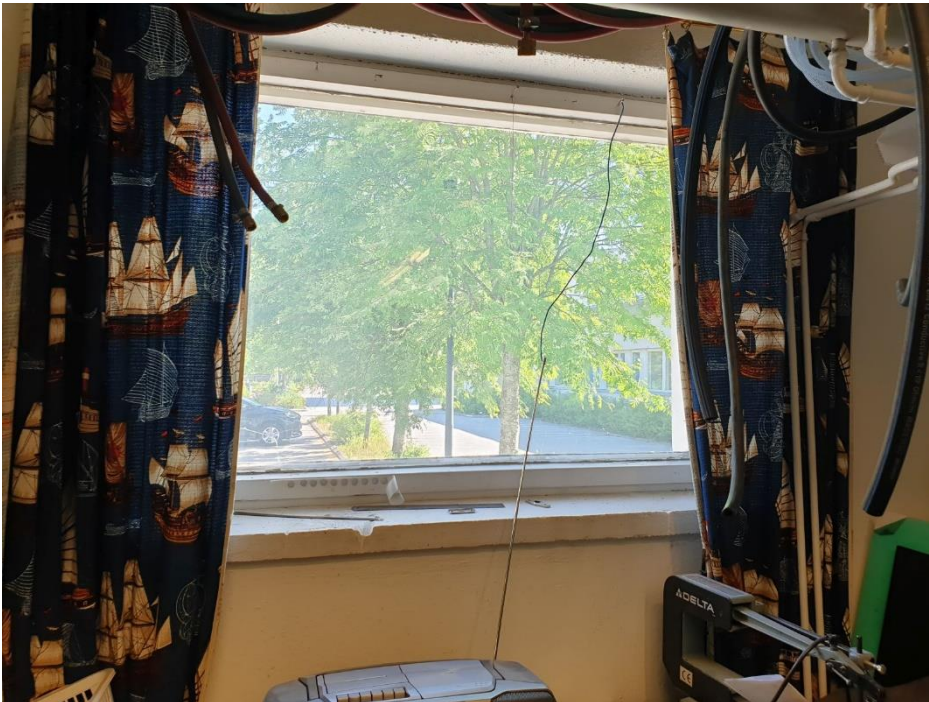
Kuva 11. Vanha osa, ikkunat, pohjoissiipi. Ikkunoiden maalipinnat ja kittikynteet mahdollisesti sisältävät haitta-aineita. Näytteet RM1 maali, RM2 kitti (Asb=asbesti, RM=raskasmetallit).
