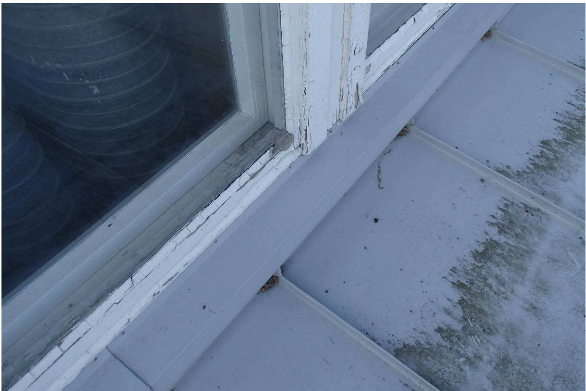
Kuva 23. Yläikkunoiden maalipinnat ovat ikääntyneet ja irtoilleet.
