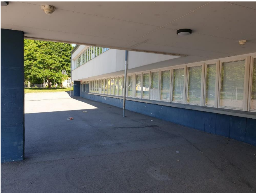
Kuva 2. Vanha osa sokkelin maalipinta maalipinnoitteet mahdollisesti sisältää haitta-aineita. Näytteet Asb/RM3 (Asb=asbesti, RM=raskasmetallit).
