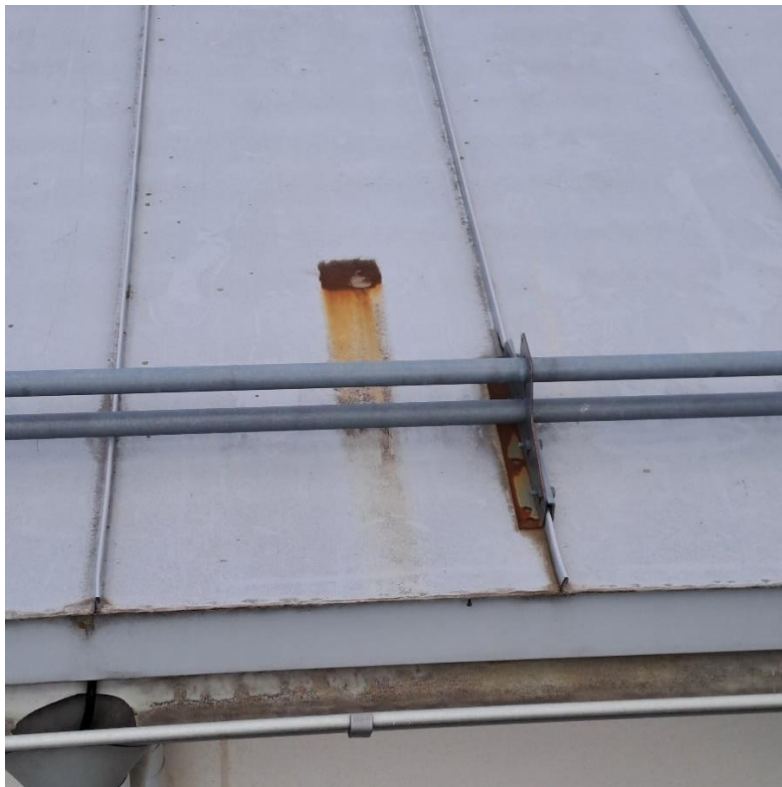
Kuva 5.25 Lumiasteiden kiinnikkeet ovat korrodoituneet.
