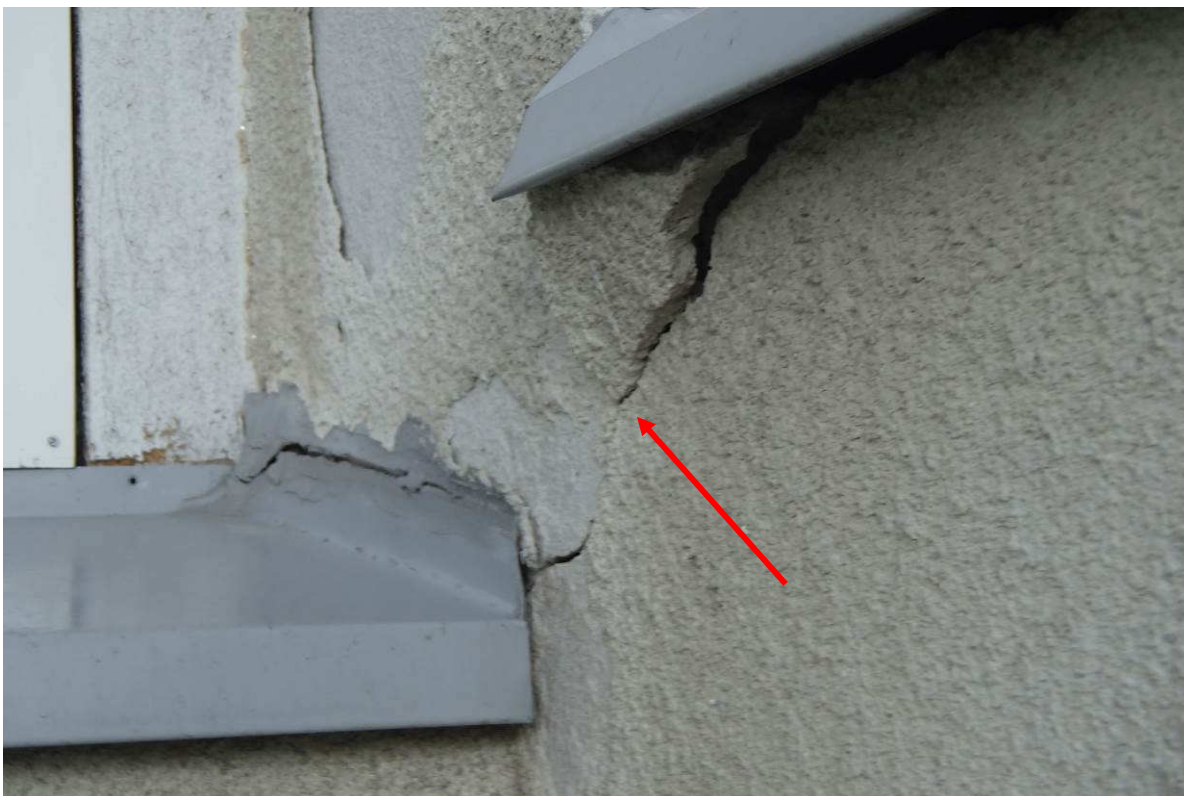
Kuva 28. Vaurioituneessa lämpörappauksessa havaittiin halkeilua.
