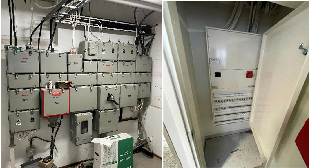
Kuvat 5.2.1-5.2.2: Vanha nousukeskus ja uusittu ryhmäkeskus.
