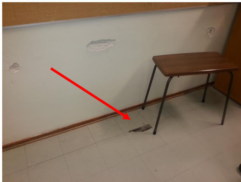
Kuva 5. rikkoutunut lattialaatta luokan 1.02 takaosassa
