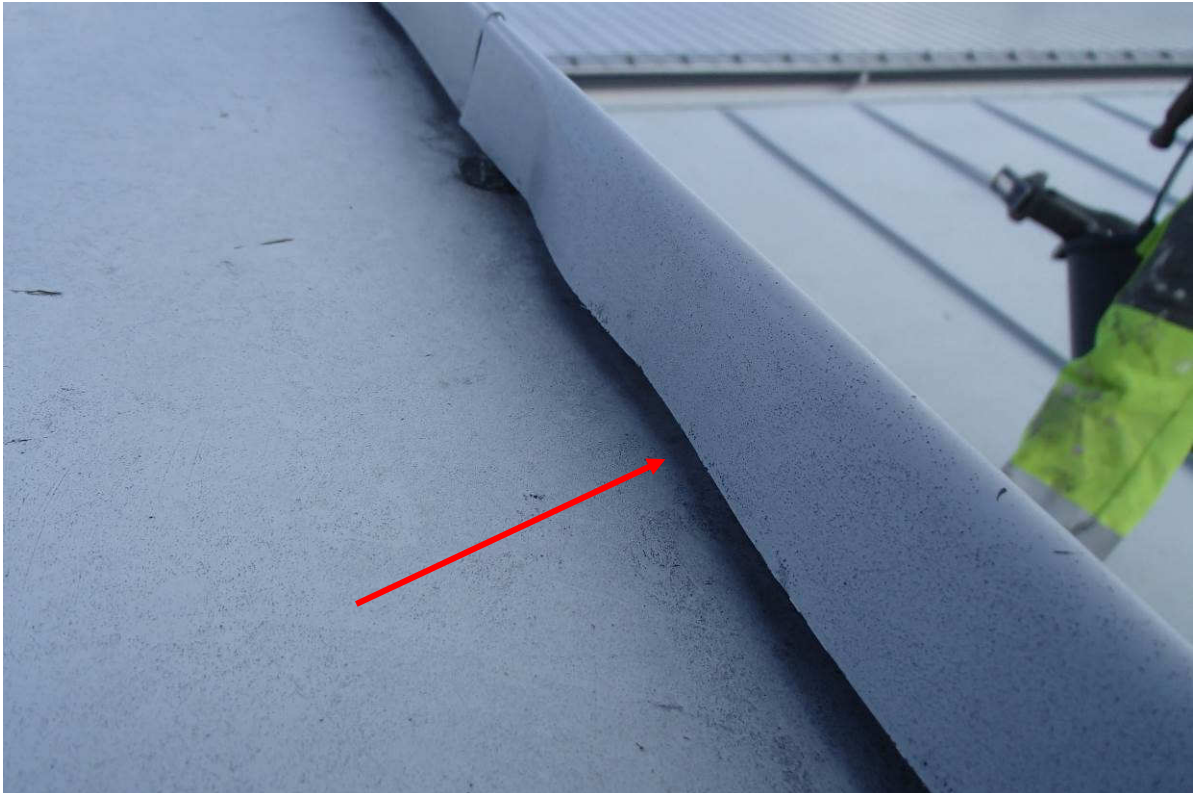
Kuva 50. Paikoin otsapellityksen liitokset eivät ole kaksinkertaiset.
