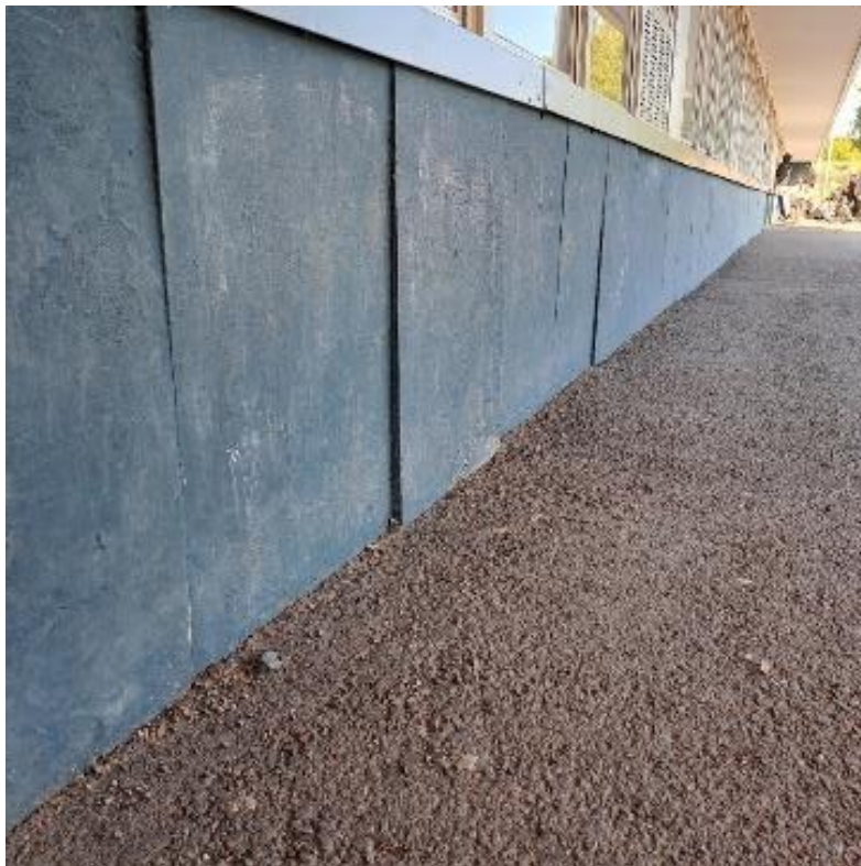
Kuva 5.6 Eteläsivulla alkuperäinen perusmuuri on ilmeisesti peitetty betonilaatoilla. Laatat hammastavat hieman toistensa suhteen.
