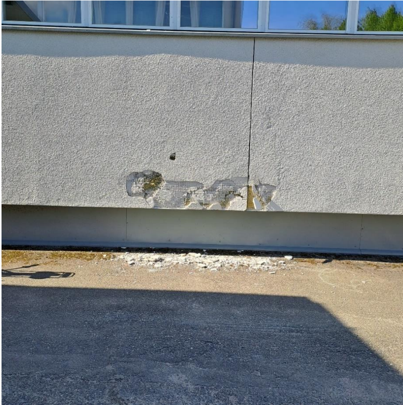
Kuva 5.1 Vaurioitunut lämpörappaus on paikoin irronnut ja paljastanut eristekerroksen.
