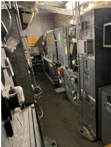
Kuva 4.3.1: B-osan ilmanvaihtokoneet TK2 ja TK3.
