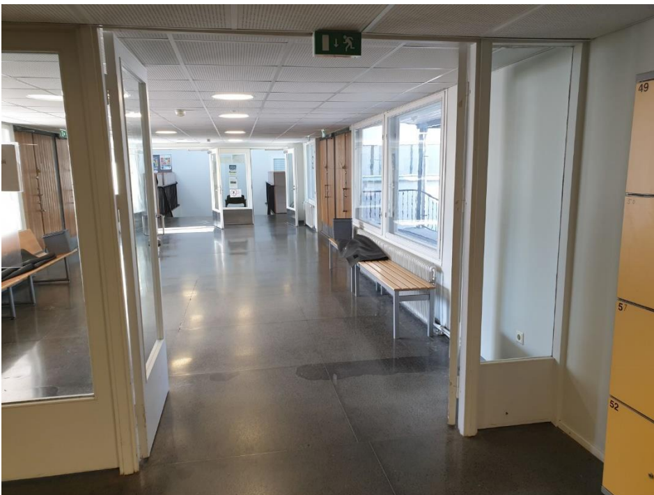
Kuva 16. Vanha osa, väliovet. Ovien maalipinnat mahdollisesti sisältävät haitta-aineita. Näyte Pb2 yhdyskäytävä (Asb=asbesti, RM=raskasmetallit).
