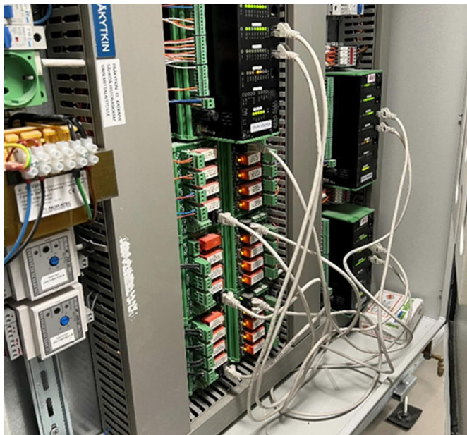
Kuva 4.5.1. Kuva A-osan 2016 peruskorjatun ilmanvaihtokonehuoneen alajakokeskuksesta
