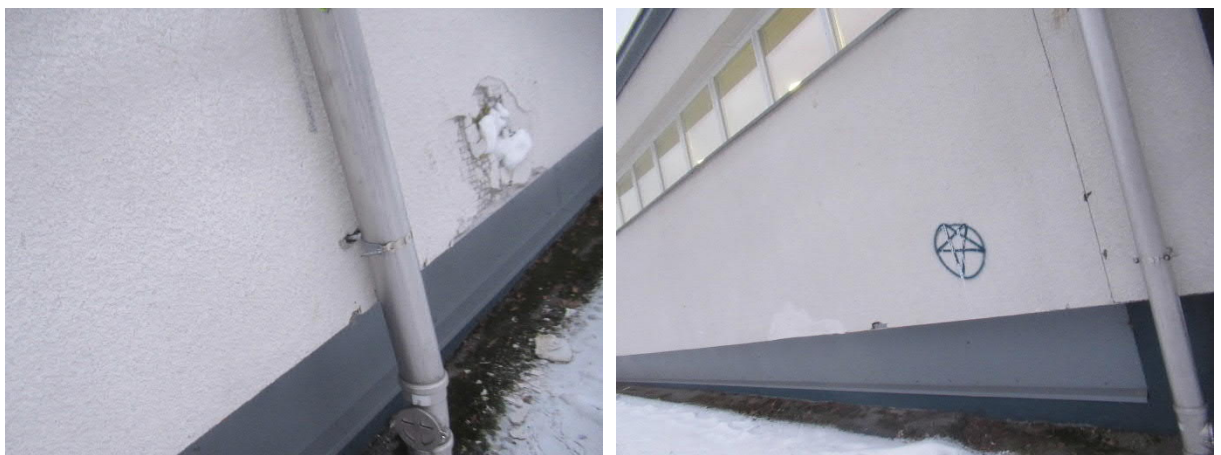
Kuvat 3.4.1-3.4.2: Rapattujen julkisivujen paikallisia kolhuja, vaurioita sekä töhryjä. Rappauskorjaukset ja rappauksen pintakäsittelyt ajoittuvat tarkastelujaksolle.
