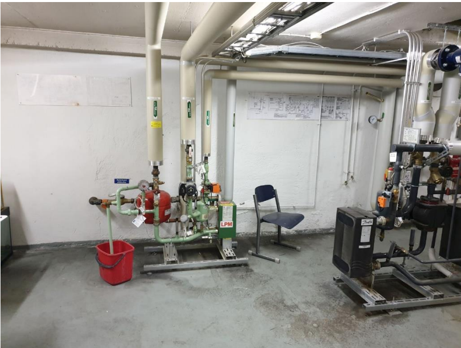
Kuva 4. Vanha osa, lämmönjakuhuone, seinien ja lattia maalipinnat mahdollisesti sisältävät haitta-aineita. Näytteet Asb/RM11 lattia, Asb/RM12 seinät (Asb=asbesti, RM=raskasmetallit).
