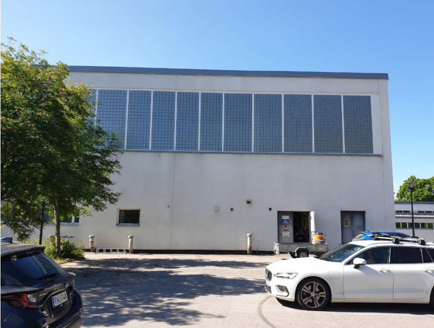
Kuva 3. Vanha osa, julkisivut, vanhan rappauksen maalipinta lämpörappauksen alla mahdollisesti sisältää haitta-aineita. Näytteet Asb/RM4, Asb/RM5 (Asb=asbesti, RM=raskasmetallit).
