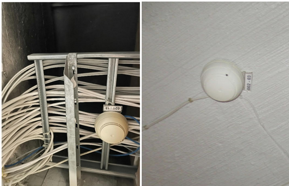
Kuvat 5.5.1-5.5.2: Esimerkkejä paloilmamaisimista.
