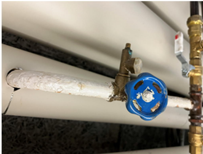
Kuva 4.1.1: Vanha lämmitysverkoston sulkuventtiili.
