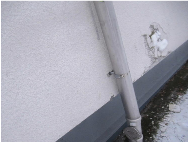
Kuva 3.5.1: Syöksytorvi, jonka seinäkiinnike on puutteellisesti kiinni.
