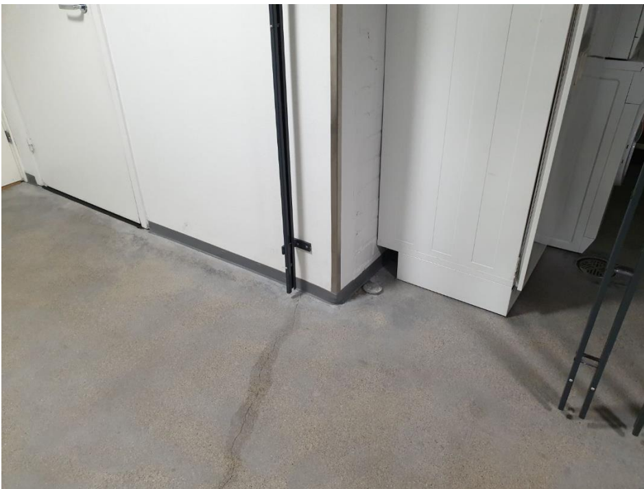
Kuva 10. 3 Vanha osa, pohjakerros, kotitalousluokka. Lattiat ja seinien maalipinnoitteet mahdollisesti sisältävät haitta-aineita. Näytteet ASB/RM24 seinät ja Asb/RM25 pilarit (Asb=asbesti, RM=raskasmetallit).
