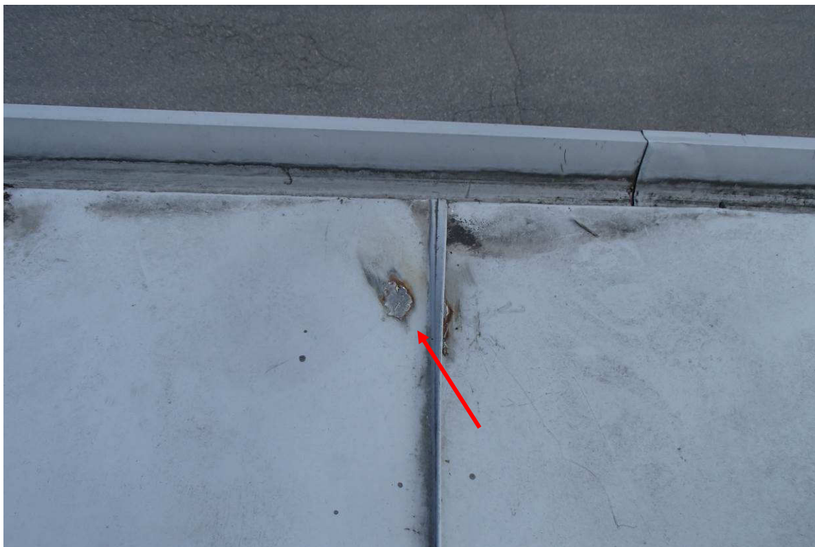
Kuva 42. Konesaumapeltikatteessa havaittiin paikattuja reikiä.
