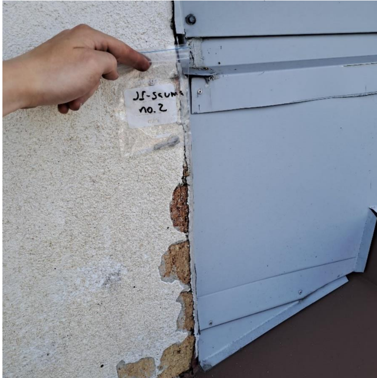
Kuva 5.18 Rappaus irronnut liitoksessa toiseen rakennukseen. Saumasta otettiin materiaalinäyte
