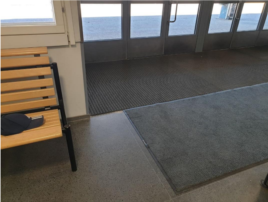
Kuva 7. Vanha osa, aula, seinien ja lattian maalipinnat mahdollisesti sisältävät haitta-aineita. Näytteet Asb/RM17 lattia, Asb/RM18 seinät (Asb=asbesti, RM=raskasmetallit). Lattian mosaiikkibetonissa on todennäköisesti kvartssia, hienojakoinen kvartsipöly tulee huomioida, jos portaita puretaan tai työstetään.
