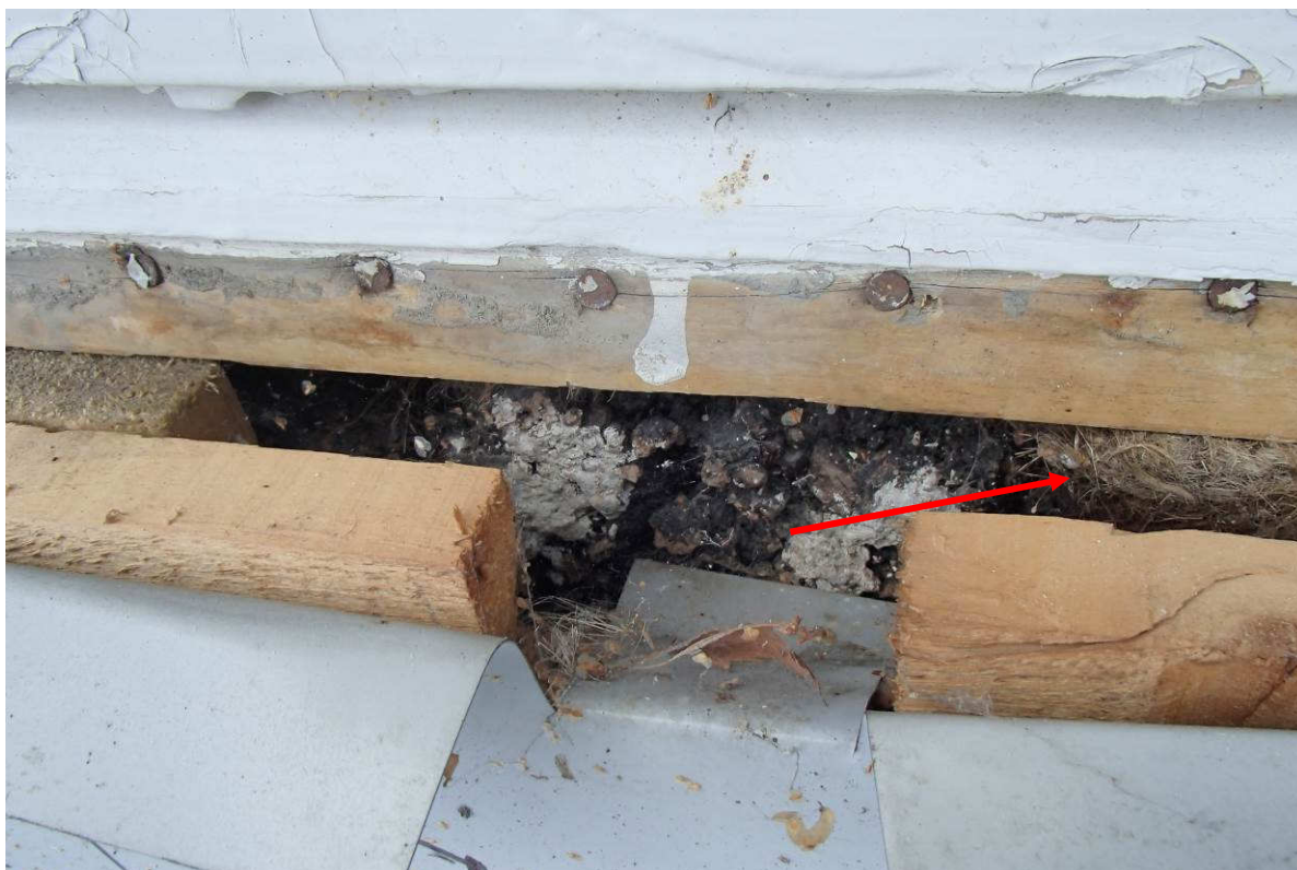
Kuva 17. Yläikkunoiden alakarmin alapuolen tilkettelässä havaittiin juutti/hamppukuitueristys.
