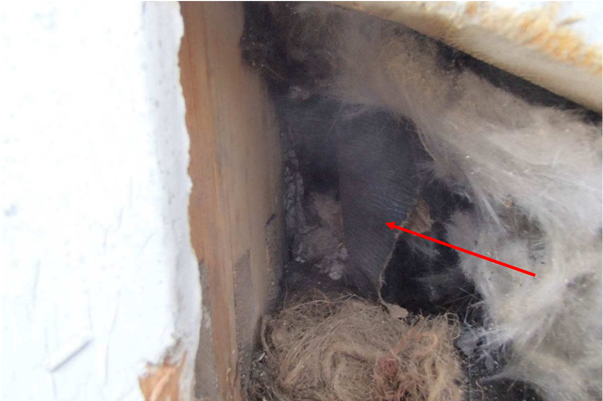
Kuva 22. Luokkien välisen eristeen taustalla havaittiin tervapaperi.
