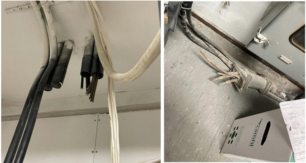
Kuvat 5.2.3-5.2.4: Vanhoja käytöstä poistettuja kaapelointeja, joissa johtimet paljaana.
