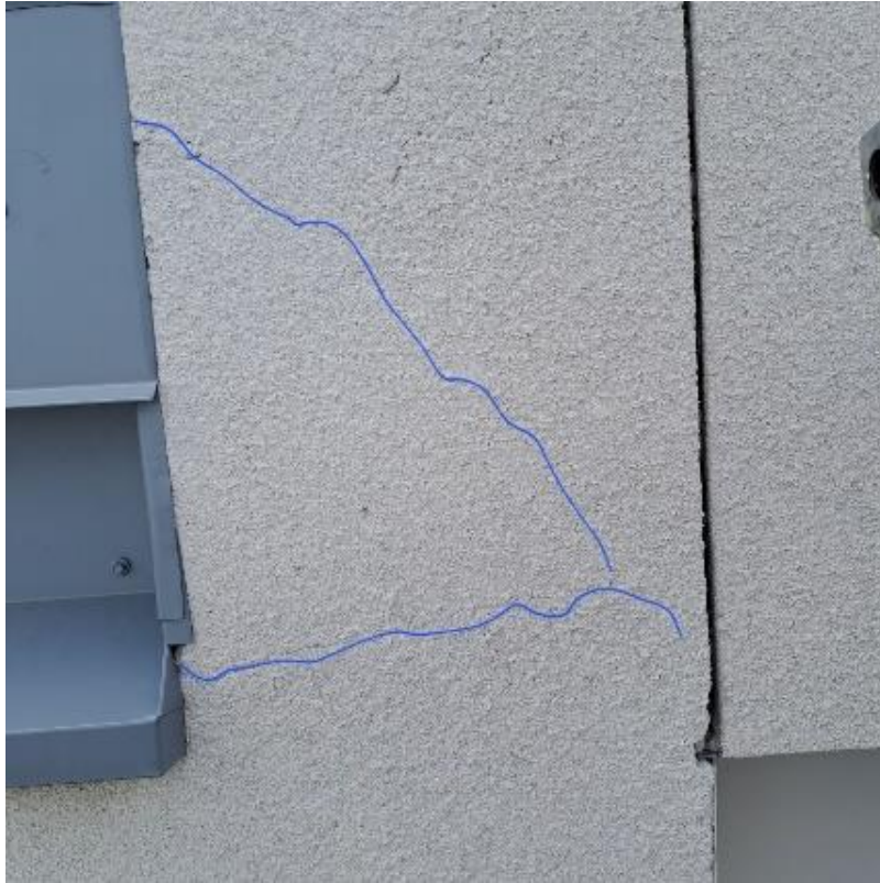
Kuva 5.3 Lämpörappauksen yksittäisiä halkeamia esiintyy lähinnä kulma/sauma-alueilla, kuten kuvassa.
