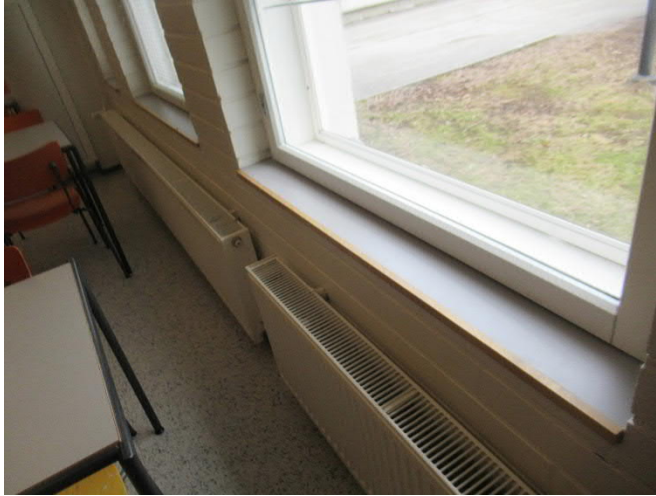
Kuva 3.4.3: Puualumiini-ikkunoiden kunnostuksiin varaudutaan tarkastelujaksolla.
