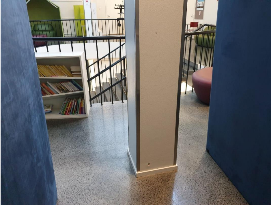
Kuva 9. Vanha osa, 2. kerros, pilarit. Pilarien ja seinien maalipinnoitteet mahdollisesti sisältävät haitta-aineita. Näytteet ASB/RM21 seinät ja Asb/RM22 pilarit (Asb=asbesti, RM=raskasmetallit). Lattian mosaiikkibetonissa on todennäköisesti kvartsia, hienojakoinen kvartsipöly tulee huomioida jos portaita puretaan tai työstetään.
