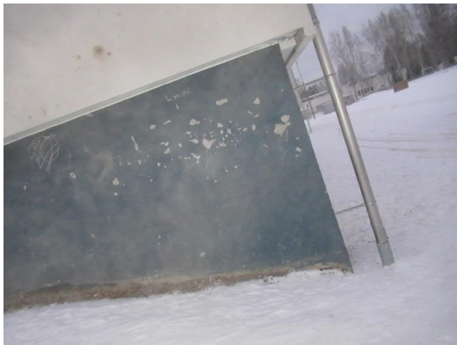
Kuva 3.2.3: Perusmuurin maalipinnan hilseilyä. Puhdistus ja ylimaalauksen aiheellista.
