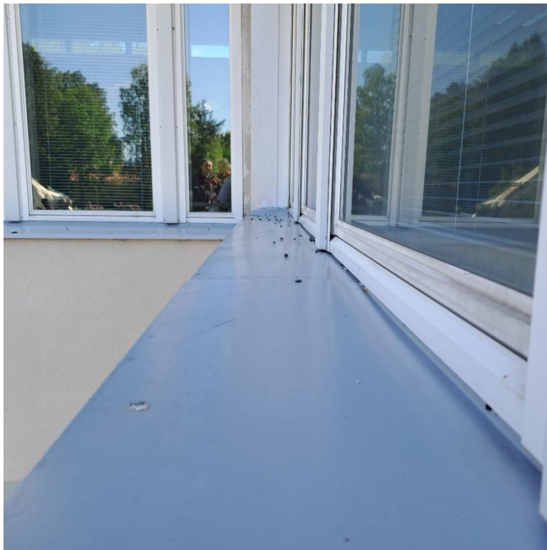
Kuva 5.8 Ikkunapellitysten kaadot ovat paikoin riittämättömät
