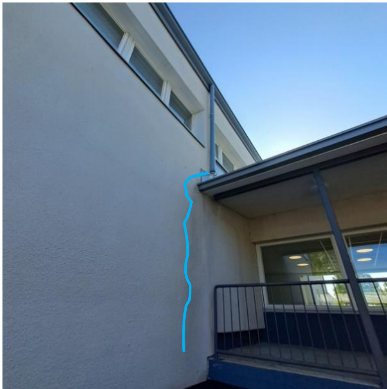
Kuva 5.14 Kuvassa näkyvä syöksy tiputtaa vedet katon reunaan suurella paineella, joka edelleen roiskuu ulkoseinään. Seinässä tummentumaa kosteusrasituksesta.
