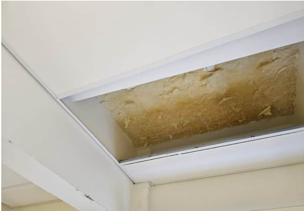
Kuva 3. Voimisteluväline-/tuolivaraston alapuoleisten tilojen alakattorakenne. Vanhoista akustiikkalevyistä on jäänyt paikoitellen villaa betonilaatan alapintaan.
