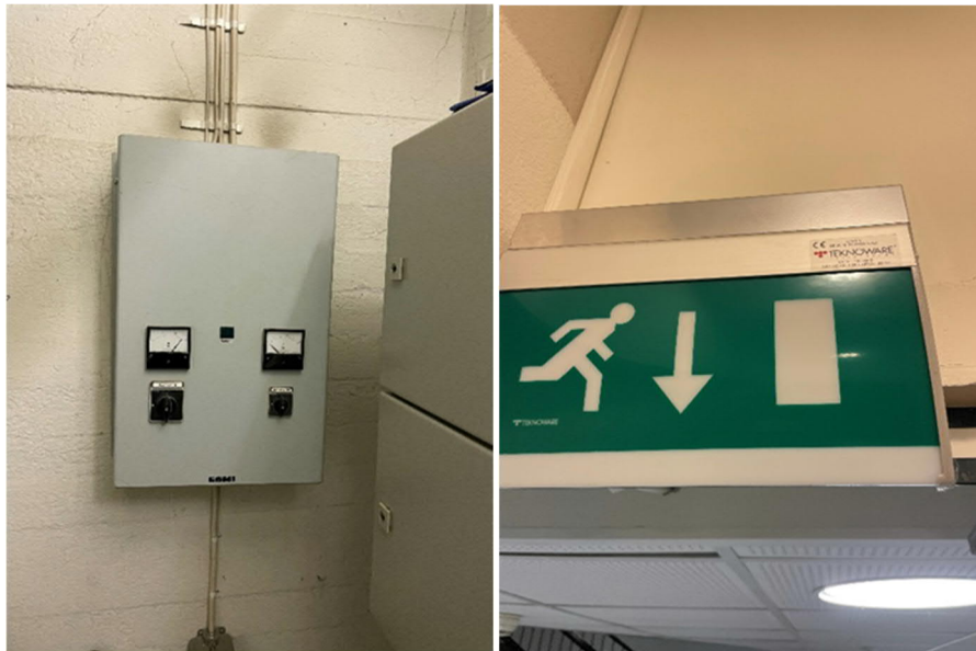
Kuvat 5.4.1-5.4.2: Turvavalokeskus ja poistumistievalaisin.
