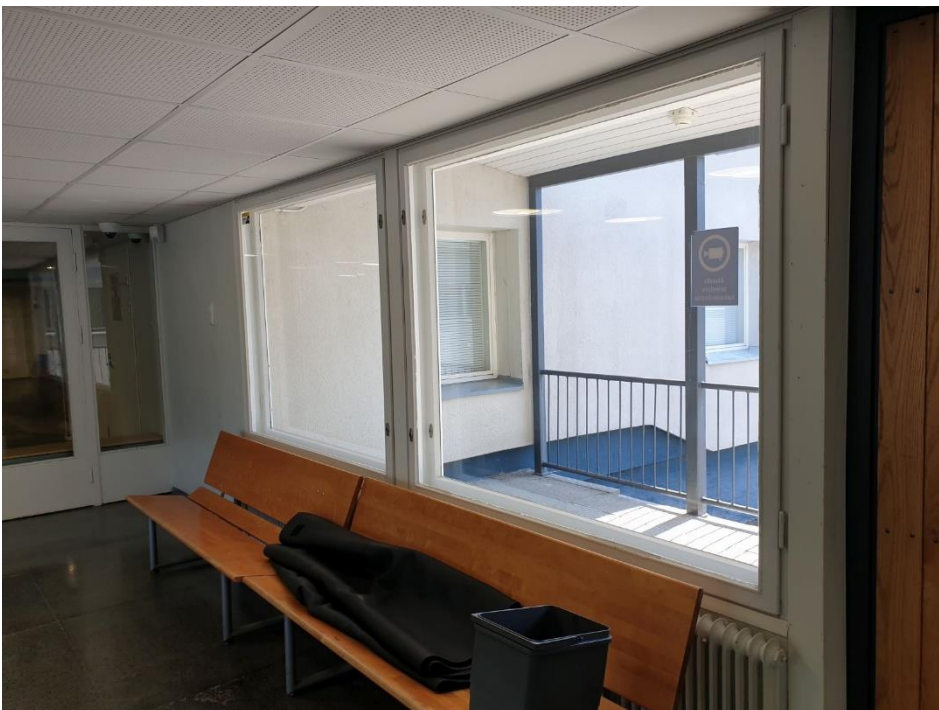
Kuva 12. Vanha osa, ikkunat, yhdyskäytävä. Ikkunoiden maalipinnat mahdollisesti sisältävät haitta-aineita. Näytteet RM3 maali (Asb=asbesti, RM=raskasmetallit).
