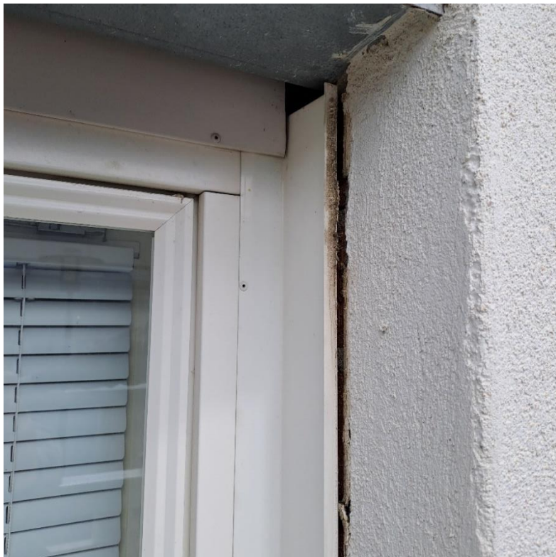
Kuva 5.29 Ikkunoiden tiiviys on paikoin puutteellinen.
