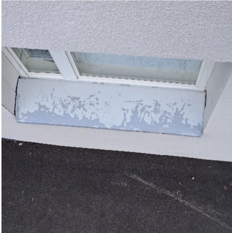
Kuva 5.9 Ikkunapellitysten liitokset ikkunapieliin ovat osin epätiivitä
