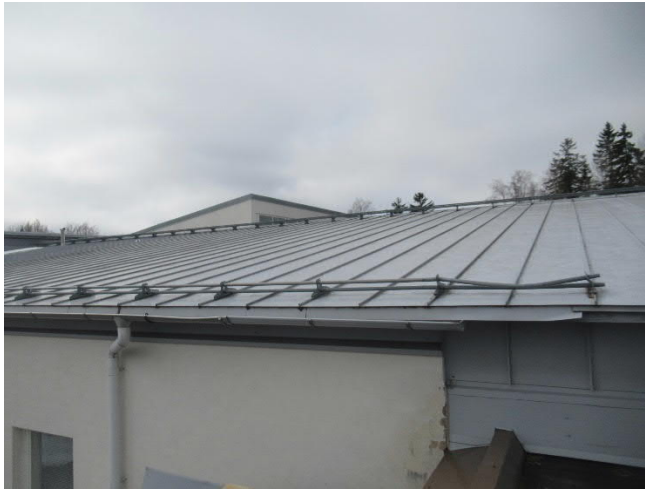
Kuva 3.5.1: Paikallisia vaurioita sadevesijärjestelmässä sekä lumiesteissä.
