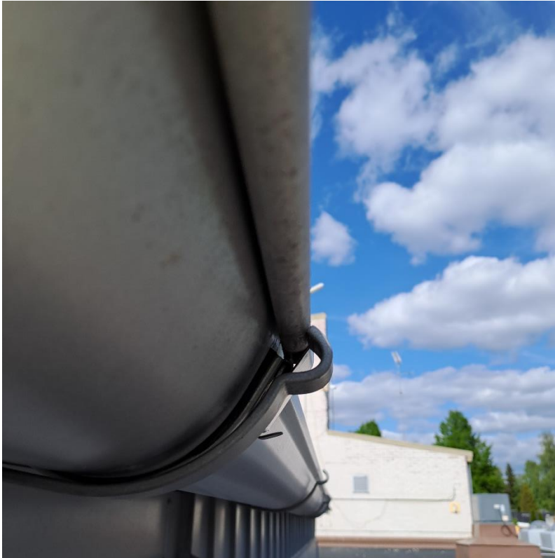
Kuva 5.25 Sadevesikouru on irronnut paikoin kannakkeistaan.
