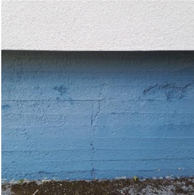
Kuva 5.5 Vanhassa pinnoitetussa sokkelissa havaittiin jonkin verran halkeamia sekä vanhoja pakkasrapautuneita kohtia.
