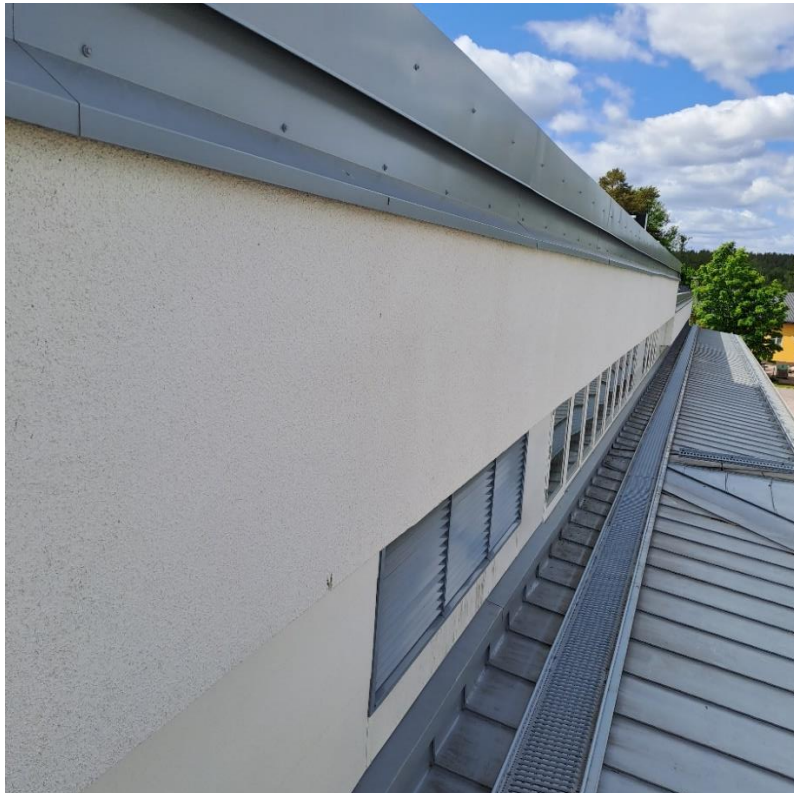
Kuva 5.4 Pääosin lämpörappaus on hyvässä kunnossa yksittäisiä vauriokohtia lukuun ottamatta.
