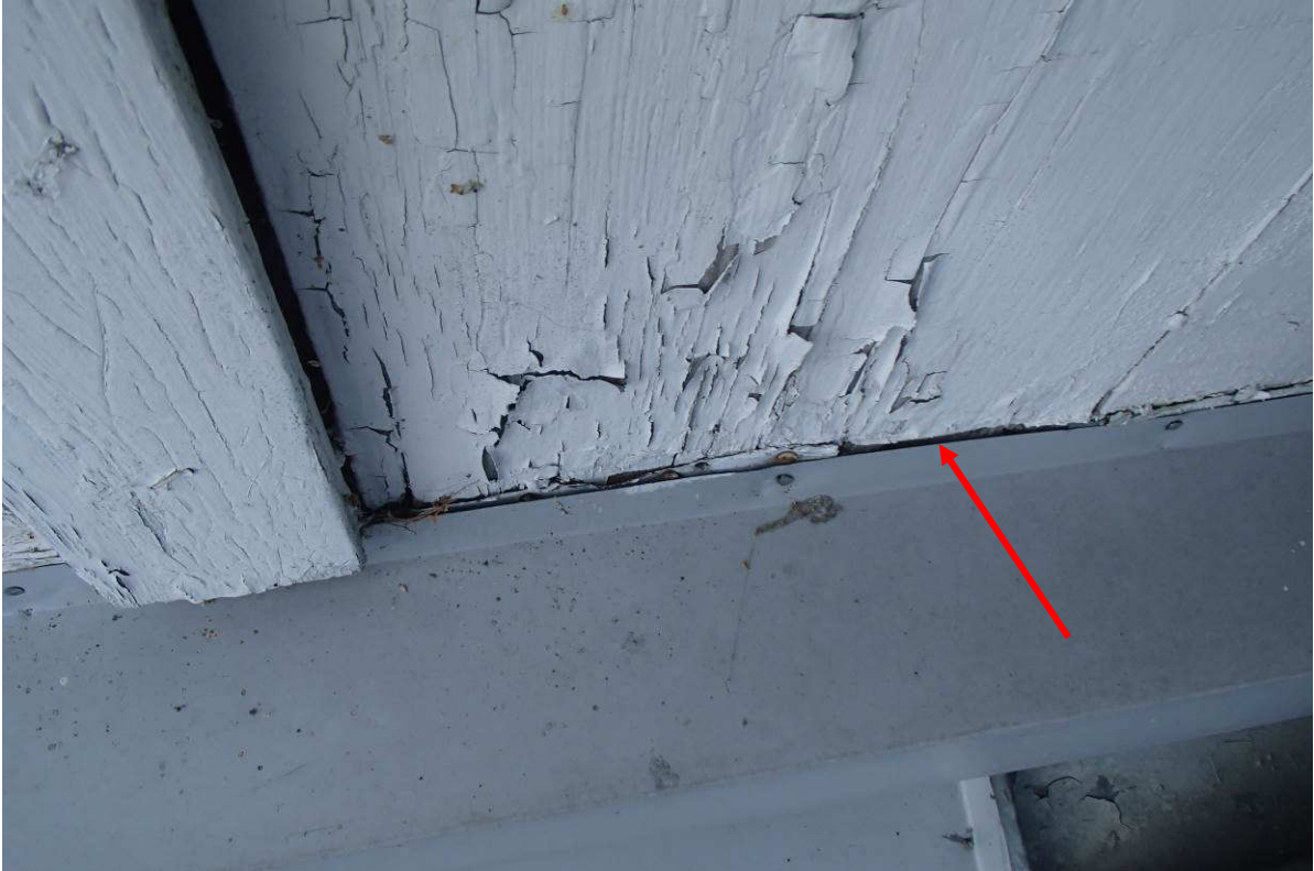
Kuva 24. Yläikkunoiden puumateriaalissa ja maalipinnoissa havaittiin ikääntymistä sekä vesipellityksen ja ikkunarakenteen välissä havaittiin rakoja.
