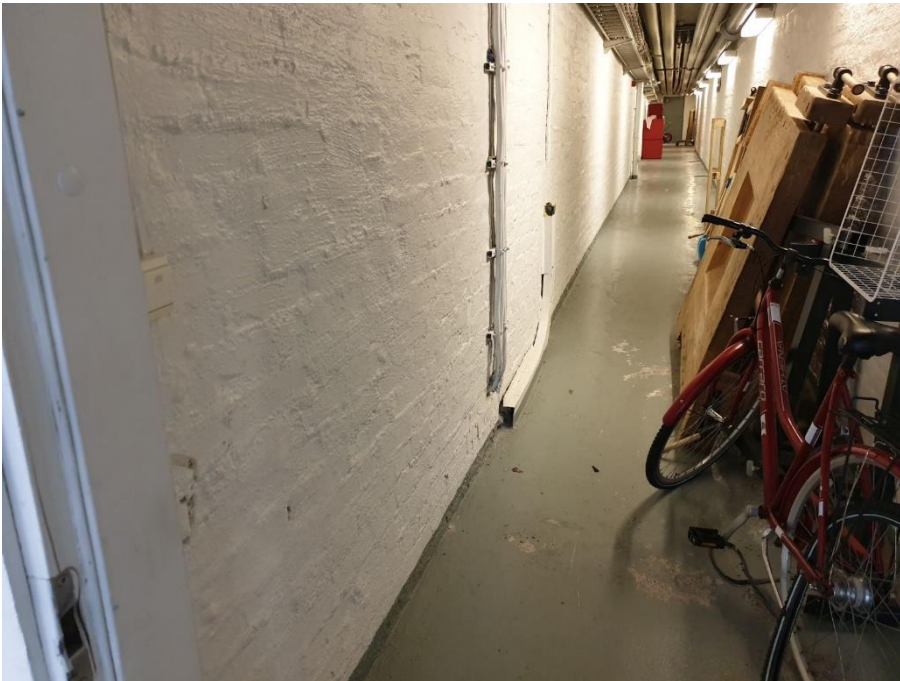
Kuva 1. Vanha osa pohjakerros, tekniset tilat. Käytävän seinän ja lattia maalipinnoitteet mahdollisesti sisältävät haitta-aineita. Näytteet Asb/RM1, Asb/RM13, lattia, Asb2/RM2, Asb/RM14 seinä (Asb=asbesti, RM=raskasmetallit).
