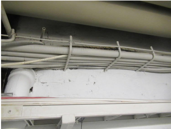
Kuva 4.2.1: Vanha muovillinen valurautaviemäri pohjakerroksen käytävätilan katossa.
