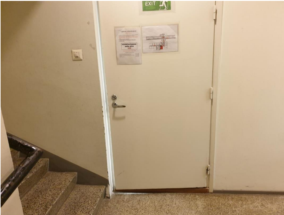
Kuva 15. Vanha osa, pohjoisosan porraskäytävän väliovet. Ovien maalipinnat mahdollisesti sisältävät haitta-aineita. Näyte Pb1 (Asb=asbesti, RM=raskasmetallit).
