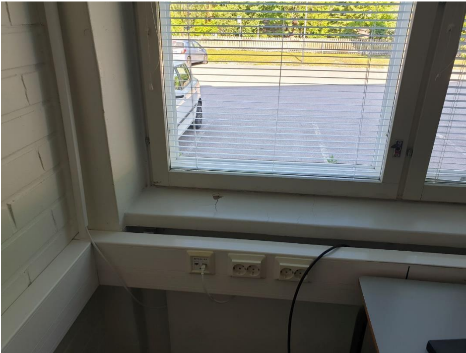
Kuva 13. Vanha osa, ikkunat. Ikkunalaudan maalipinnat mahdollisesti sisältävät haitta-aineita. Näyte RM6 maali (Asb=asbesti, RM=raskasmetallit).
