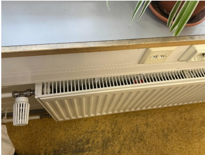
Kuva 4.1.1: Luokkahuoneen lämmityspatteri ja termostaattiventtiili
