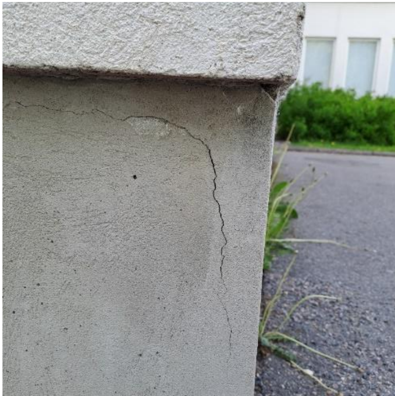
Kuva 5.23 Sokkelin kulman lohkeama
