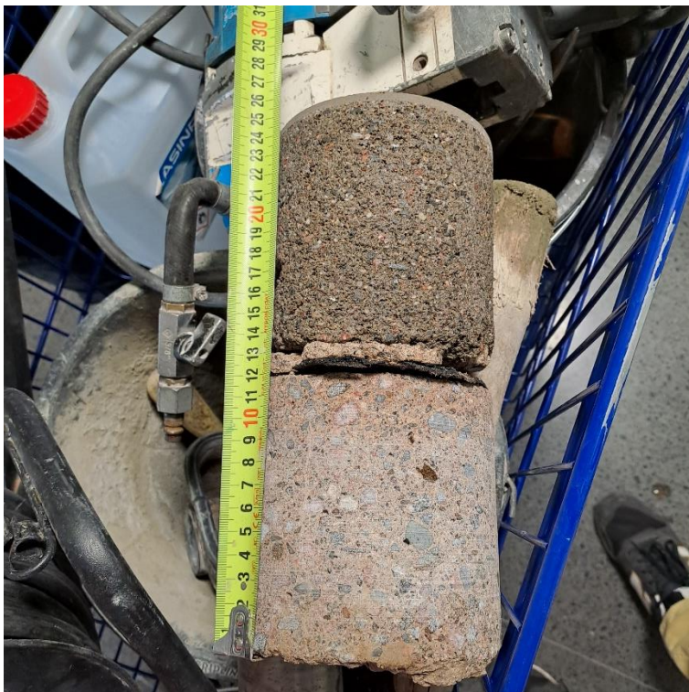
Kuva 4.3 Taukotilan alapohja on suhteellisen paksu, vesieristeen yläpuolinen betonivalu on huokoinen ja rapautunut
